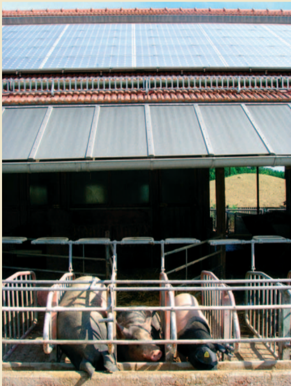
Wenn's den Schweinen zu warm wird, arbeitet die Solaranlage auf Volllast
